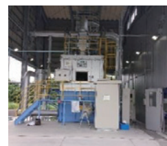
粃殻再資源化焼却施設燃焼プラント
