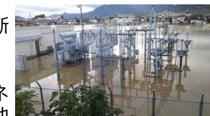
台風により水没した変電所
