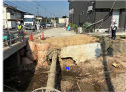
本木川 護岸崩壊の状況 (福津市畦町)
