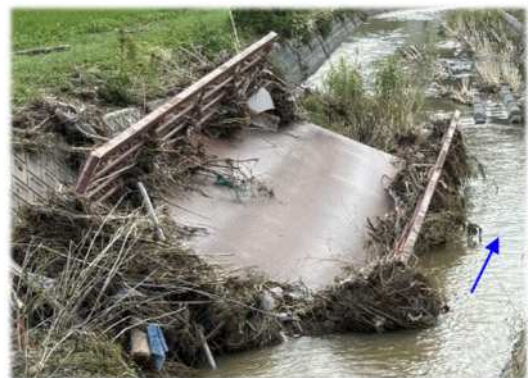
本木川 市道橋の落橋状況（福津市畦町）
