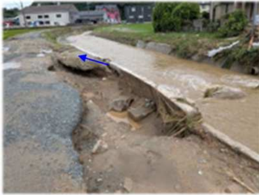
本木川 堤防越水の状況 (福津市内殿)
