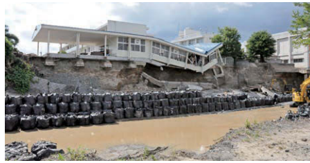
土砂くずれによる建物の倒壊
