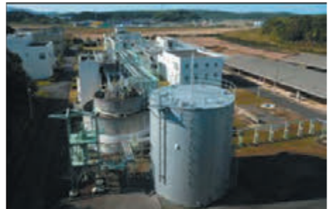
岡垣町浄化センター(岡垣町)
