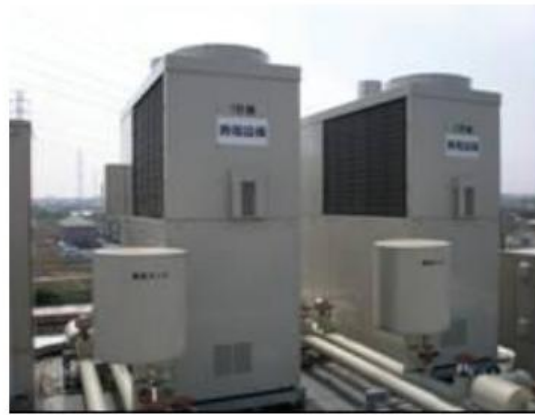
②停電対応型 CGS 形式：CP25VB2Z-TP 発電出力：25kW × 2 台 メーカー：ヤンマーエネルギーシステム(株)
