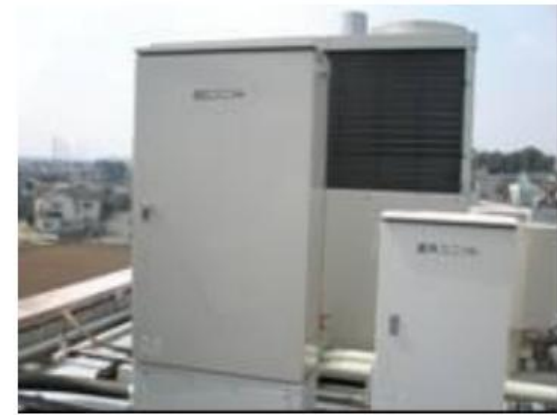
③自立ユニット(手前左) 形式：CP25VB3Z メーカー：ヤンマーエネルギーシステム(株)
