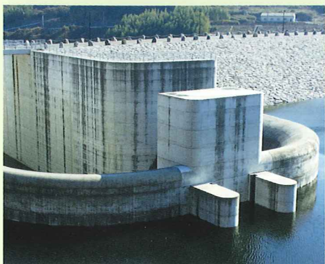
非常用洪水吐き
