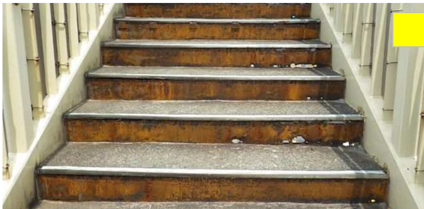
鋼材腐食状況
