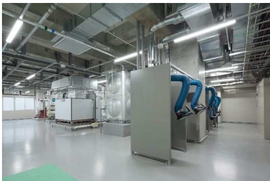
(実習棟3階 実習場 (冷凍空調システム科))
