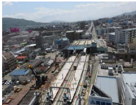
(春日原駅周辺) 駅部北側で令和元年度に春日原駅のホーム下から想定外の支障物(基礎コンクリート等)が見つかり撤去作業に時間を要していましたが、令和2年夏までにすべての撤去が完了する予定です。支障物の撤去が完了したところは、杭打ち機で杭基礎を施工し、その後順次高架構造物を建設していきます。
