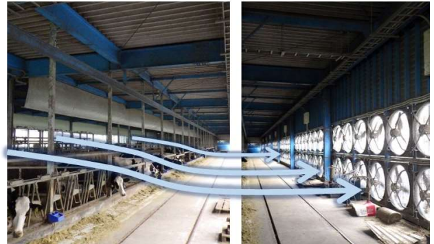
次世代閉鎖型牛舎：壁一面に設置した換気扇で強力に換気
