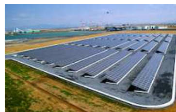
太陽光発電施設
