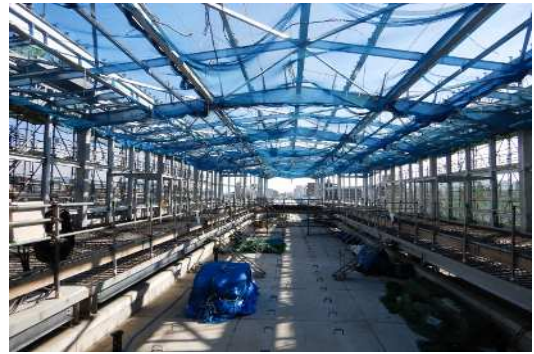
(建築中の白木原駅(高架上)) 新駅舎の屋根やホーム部の建築が進んでいます。
