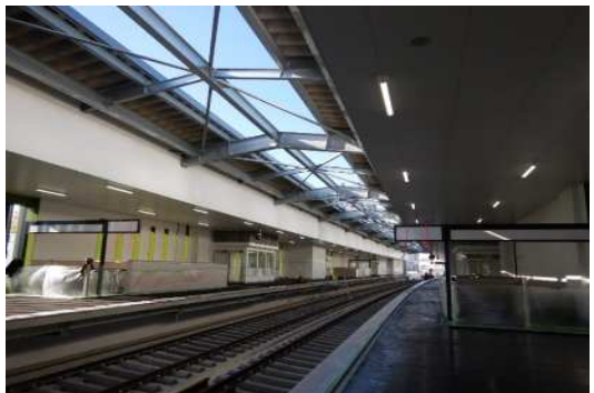
(建築中の下大和駅(高架上)) 新駅舎軌道階の建築が進んでいます。
