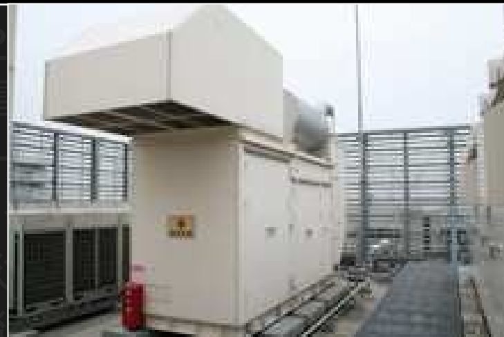
屋上に重油を利用する設備
