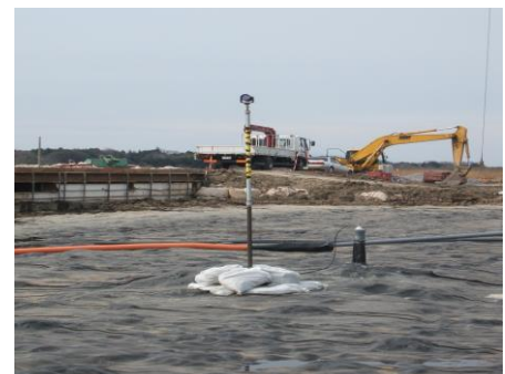
計測機器(圧力計、沈下板)
