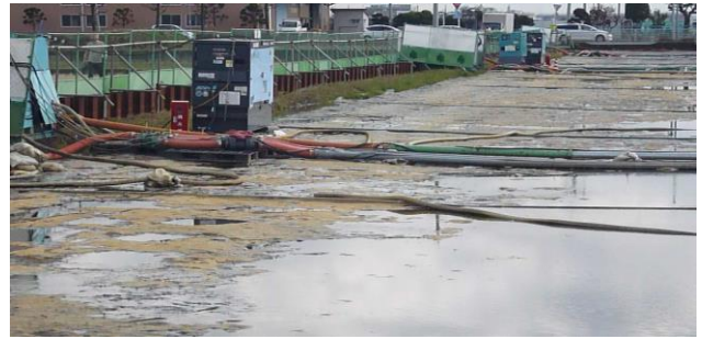
真空設備設置状況
