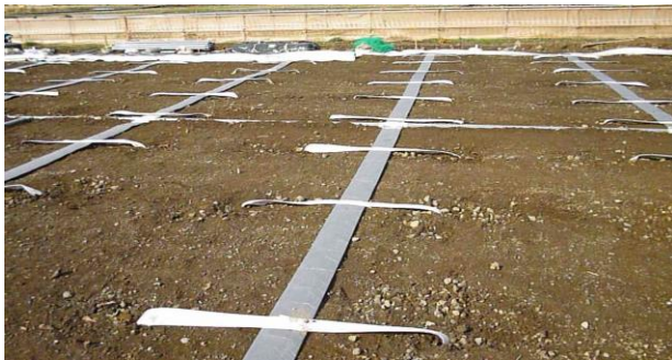
水平ドレン・配管状
