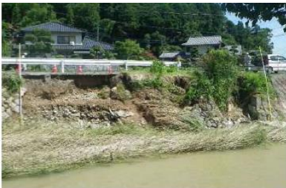
道路復旧状況 桂川下秋月線（桂川町）
