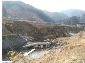
河川復旧状況 中元寺川（添田町）
