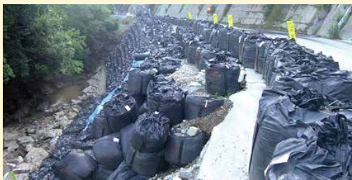
大雨により、道路擁壁が崩壊（応急工事後）
