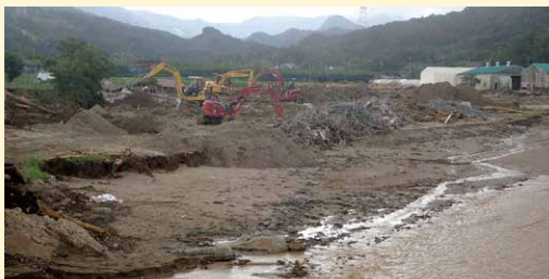
大雨により、ビニールハウスが倒壊
