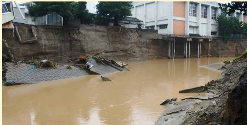
大雨により増水し、護岸が崩壊した桂川
