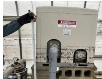
冠水した給水ポンプ(朝倉市)
