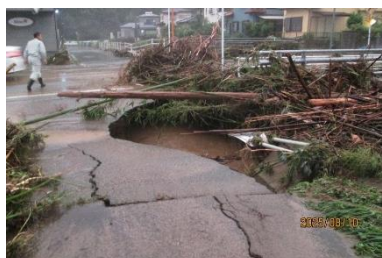
河川施設の被害(福津市(R7))
