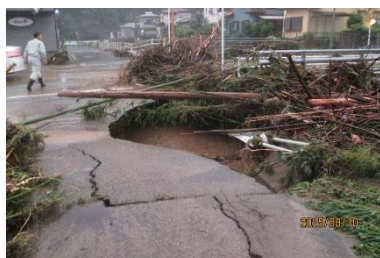
河川施設の被害(福津市(R7))
