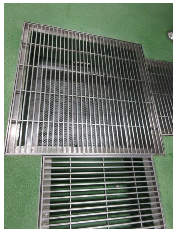
ステンレス製グレーチング付き排水溝・床
