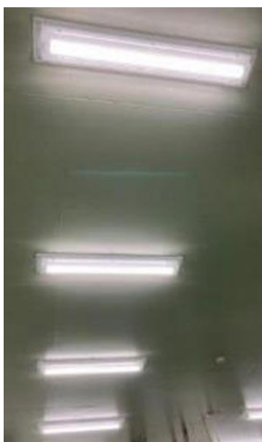
カバー付き照明が埋め込まれた天井
