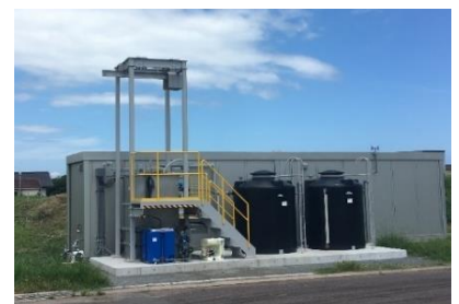
築上町が建設した新技術を用いた 液肥濃縮施設
