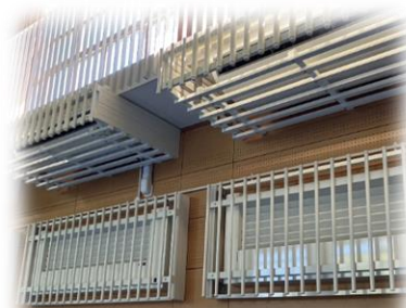
<輻射パネル × パッケージエアコン>
