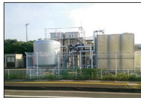
当社施工のBCP水処理設備
