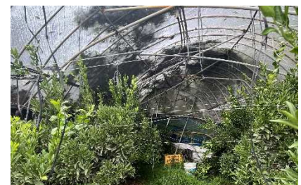
▲被災したハウス施設
