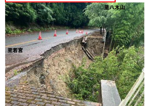
路肩崩壊 全面通行止め 8/11 1:25～ (一) 八木山若宮線（宮若市下）
