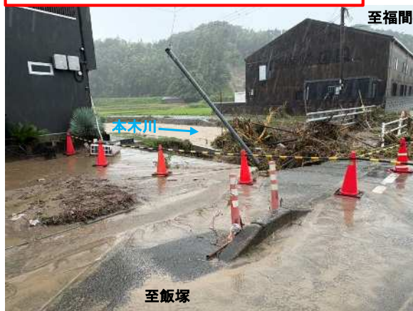
橋梁護岸洗堀 全面通行止め 8/10 19:50～ (主) 飯塚福岡線（福津市内殿）
