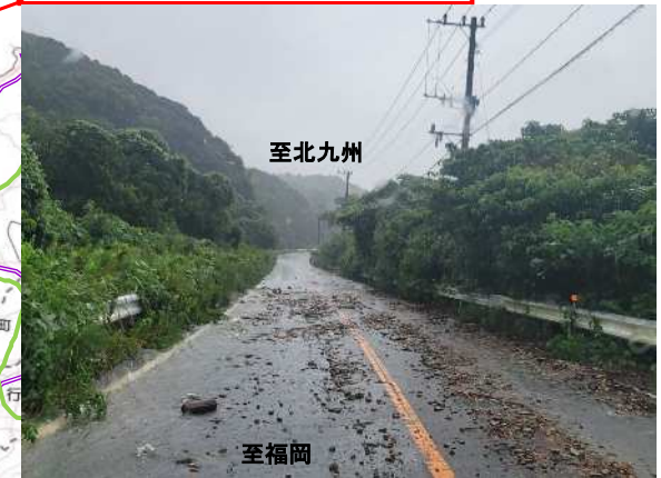
落石 全面通行止め 8/10 19:15～ (国) 495号（岡垣町～宗像市）
