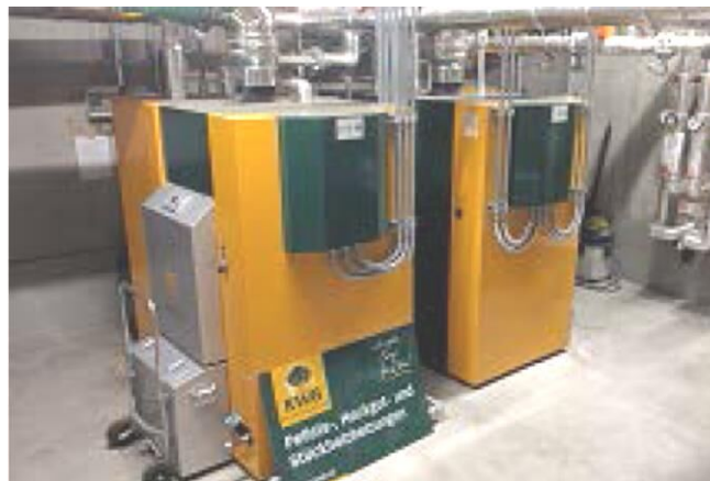
チップボイラーの例
