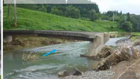
【被災状況(南関町関下地内)】
