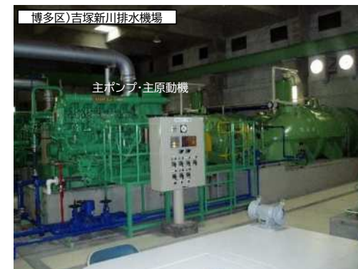
博多区)吉塚新川排水機場
