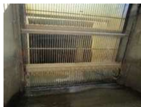
除塵機劣化状況
