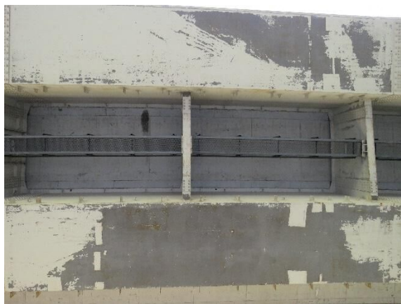
写真-2 塗膜剥離状況（下フランジ下面）
