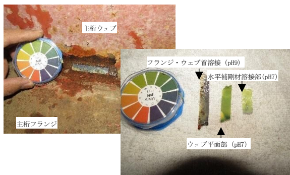
写真-2 損傷状況
