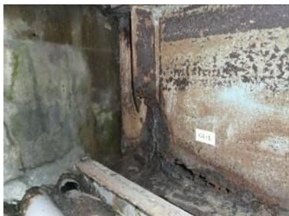
写真-1 損傷状況
