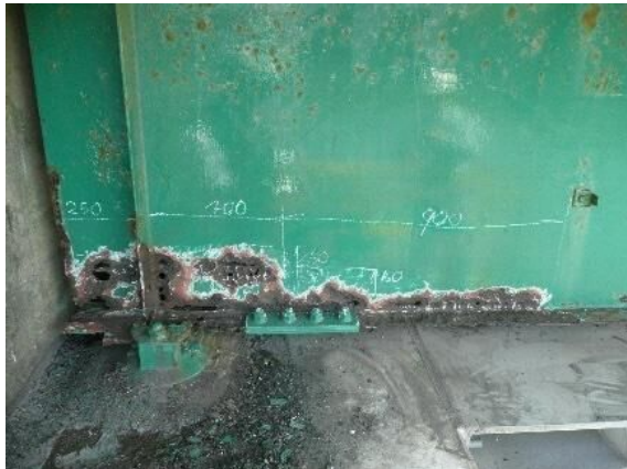
写真-1 損傷状況（Rc-Ⅲ塗替え後 4 年）
