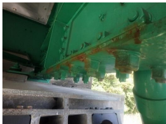
写真-3 桁端部の状況（Rc-Ⅰ塗替え後 3.5 年）
