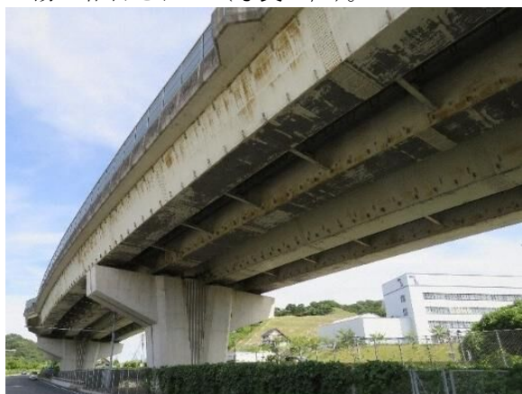
写真-1 塗膜剥離状況
