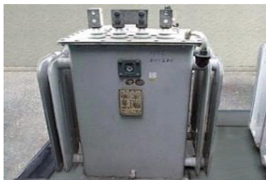
変圧器（トランス）
