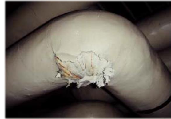
石綿保温材（レベル2）
