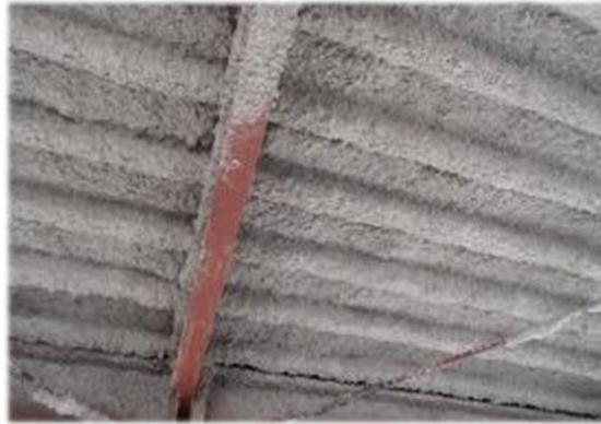
吹付け石綿（レベル1）
