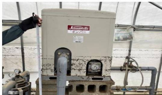
冠水した給水ポンプ (朝倉市)
