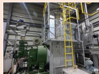
～バイオマスバーナー～ 蒸気ボイラー設備への導入事例
