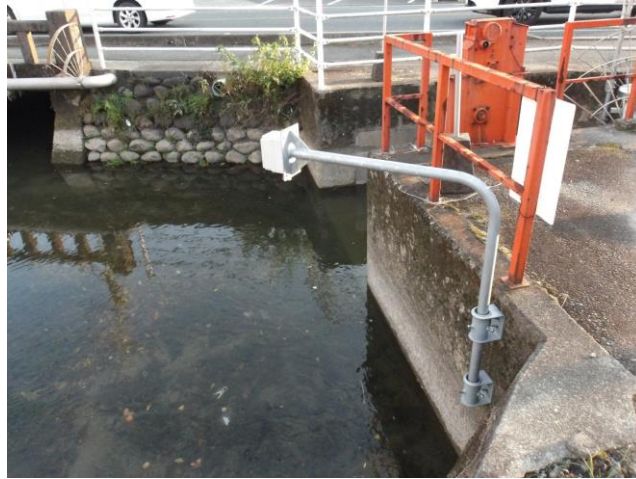
写真 4-24 危機管理型水位計の設置状況(八女市の例)
