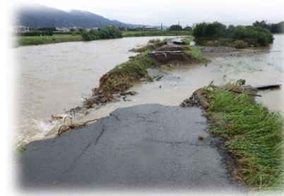
<巨瀬川の被害状況>
