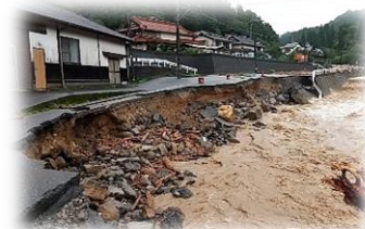
<被災した道路>
