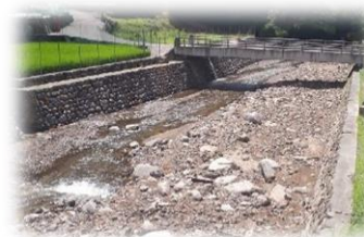
<土砂堆積の様子>
