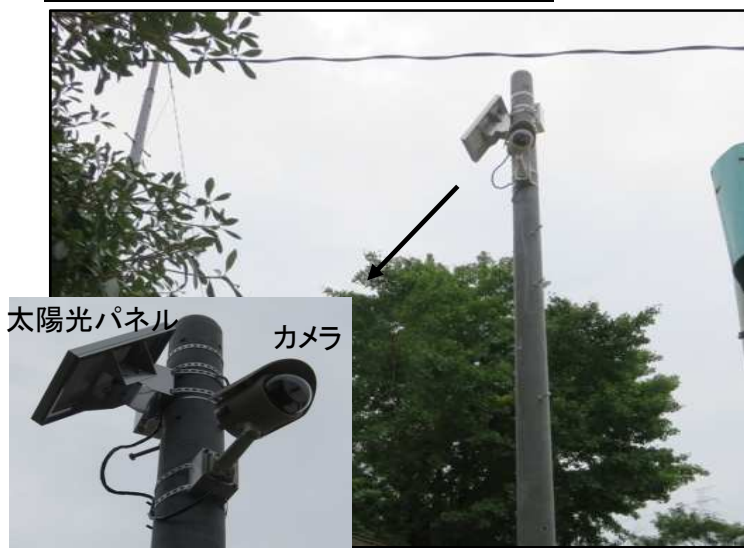
簡易型河川監視カメラ設置(例)
