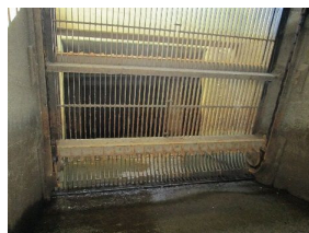
除塵機劣化状況
