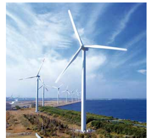
▲風力発電設備
