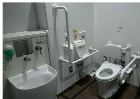
多目的トイレ L型手すりやオストメイト設備を完備
