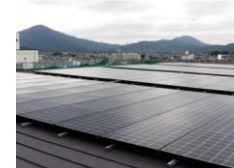
太陽光発電設備
