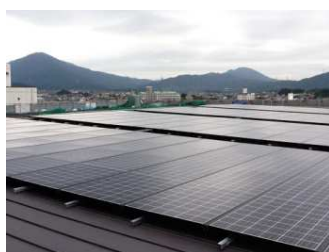
太陽光発電設備
