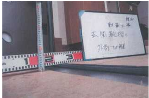
34. 玄関の出入口の段差
