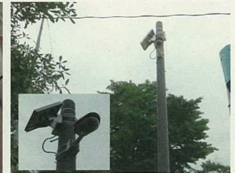
簡易監視カメラ設置(例)
