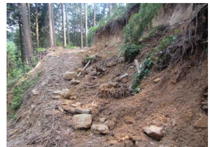
被災した森林作業道
