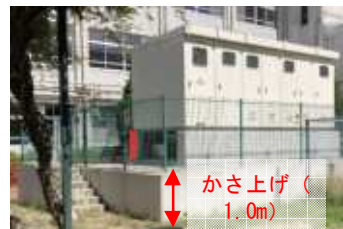
【第2受変電設備】
