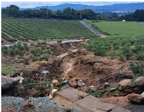
茶園の法面崩壊（広川町）
