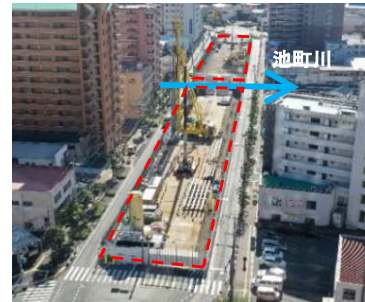
池町川(地下調節池)
