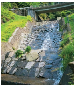
山の地形を生かし、滝の下流に取水口を設置。発電機までの30mの落差を利用して発電が行われる
