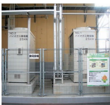
発酵してできたガスをエネルギー源として発電するバイオガス発電機
