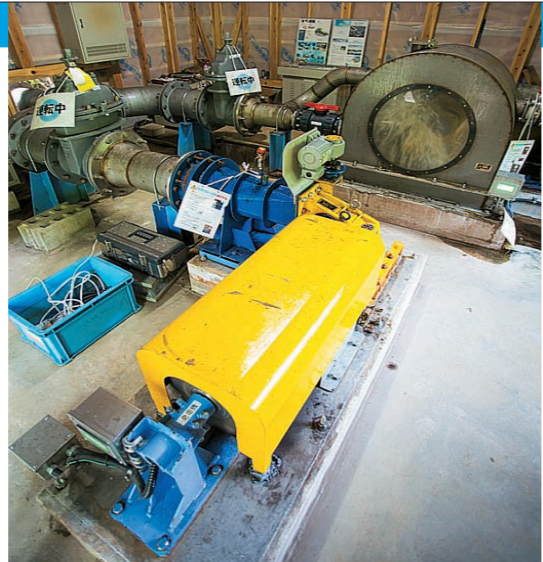
小水力発電所には最大出力5kWh・最大出力10kWhの2基の水車を設置。平成27年度は7万5907kWhを発電
