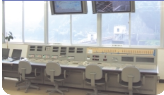
クレストゲート等のダム設備の操作を行うための機器です。
