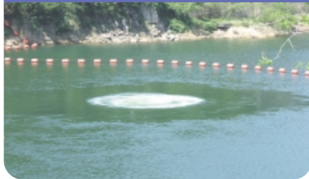
ダム湖の水を攪拌させ水質を改善するための設備です。
