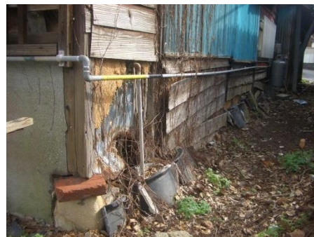
破損箇所のズーム（拡大）写真
